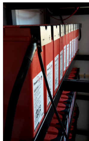
Figur 15: Blybatterilager, solcellsanläggning i Glava
