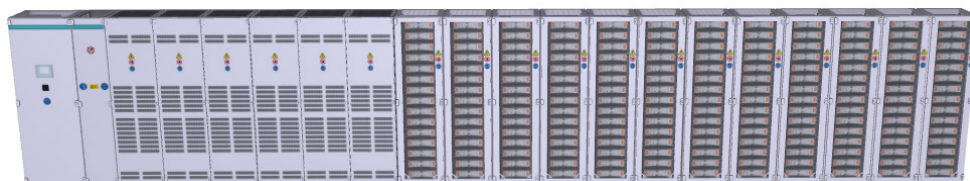
Figur 20: Batterilager på 2,7 megawattimmar med växelriktare och kontrollskåp 84
