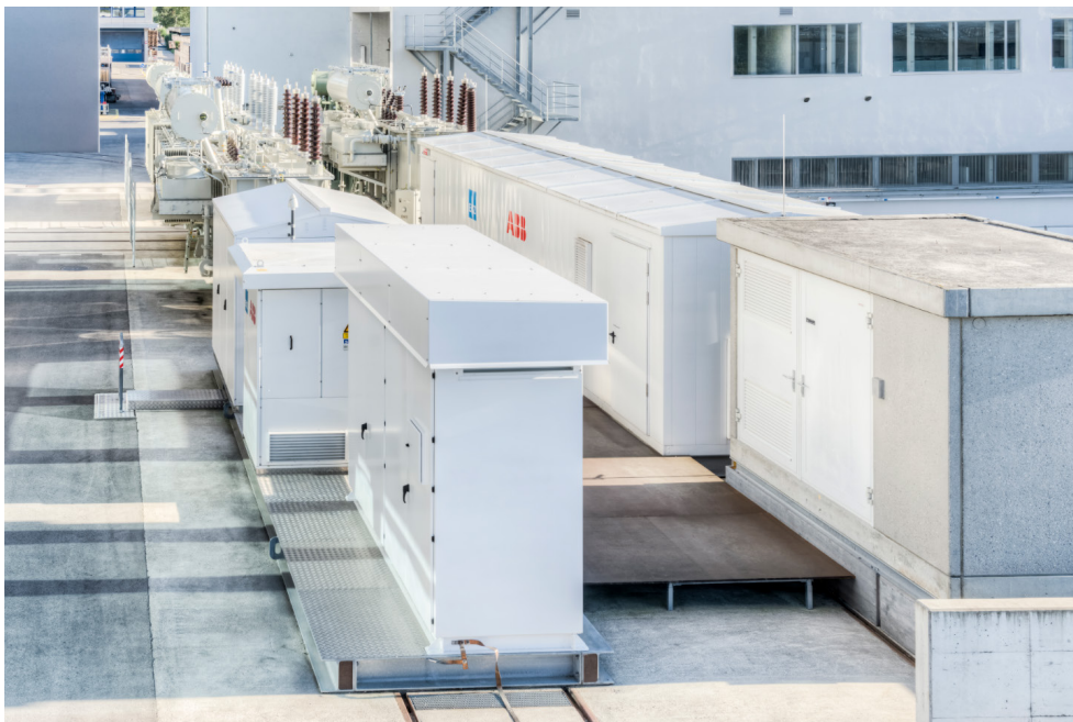
Figur 17: Batterilageranläggning med transformator station 76
